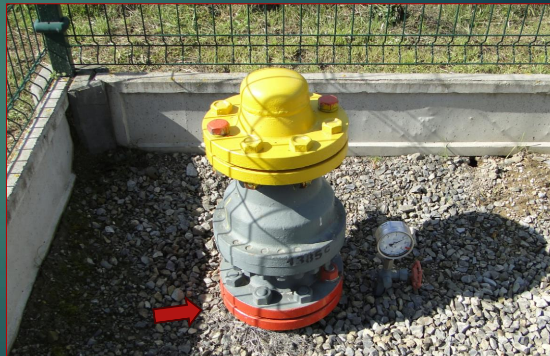
Kurek kulowy zbyt nisko posadowiony względem poziomu terenu
