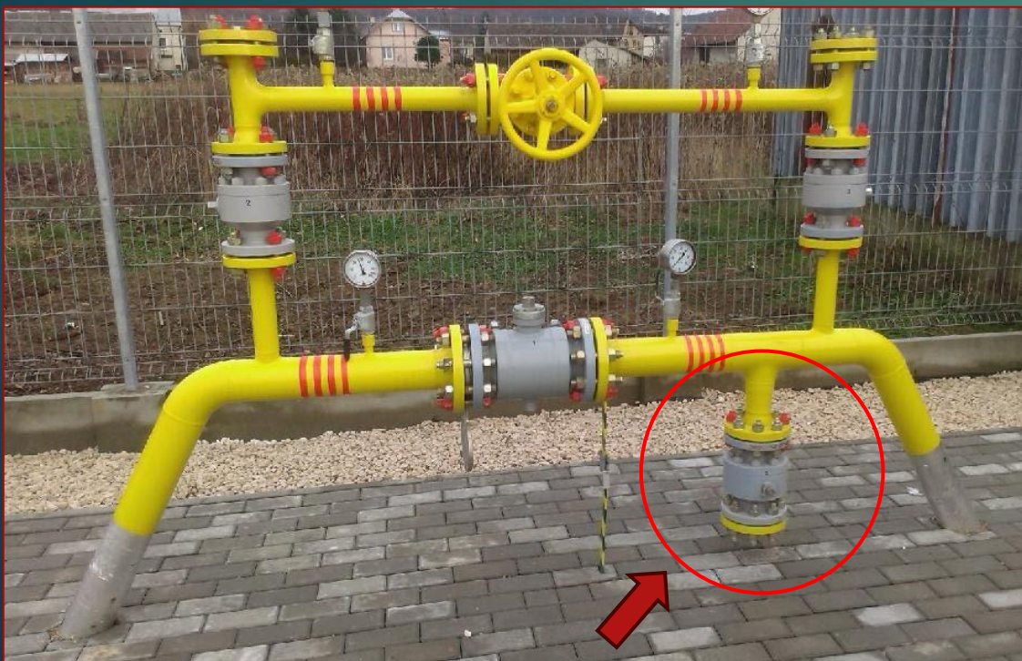
ZZU zbyt nisko posadowiony względem poziomu terenu
