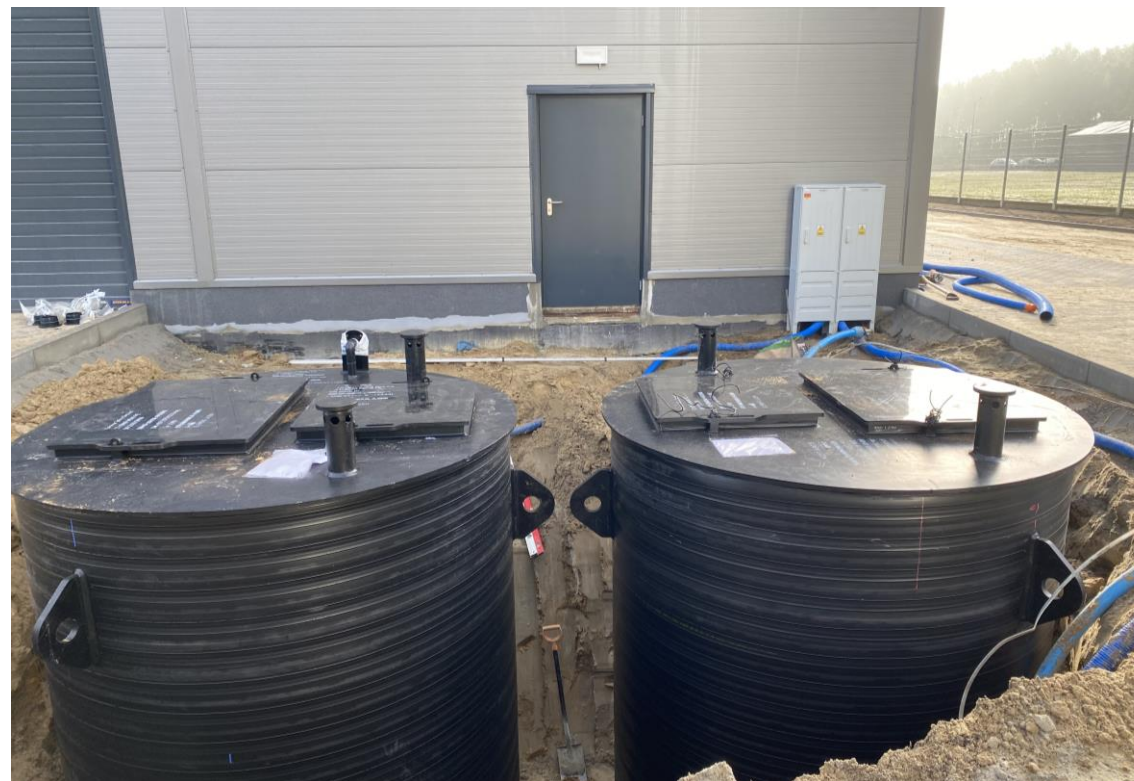
Pompownie PPOŻ podziemne
