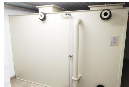
Zbiornik magazynowy wody
