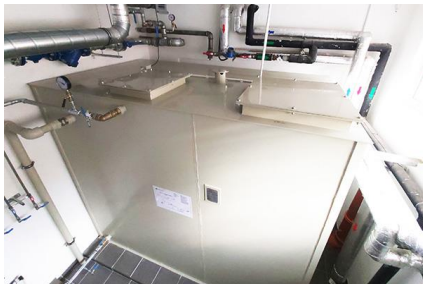
Zbiorniki rezerwowe wody pitnej
